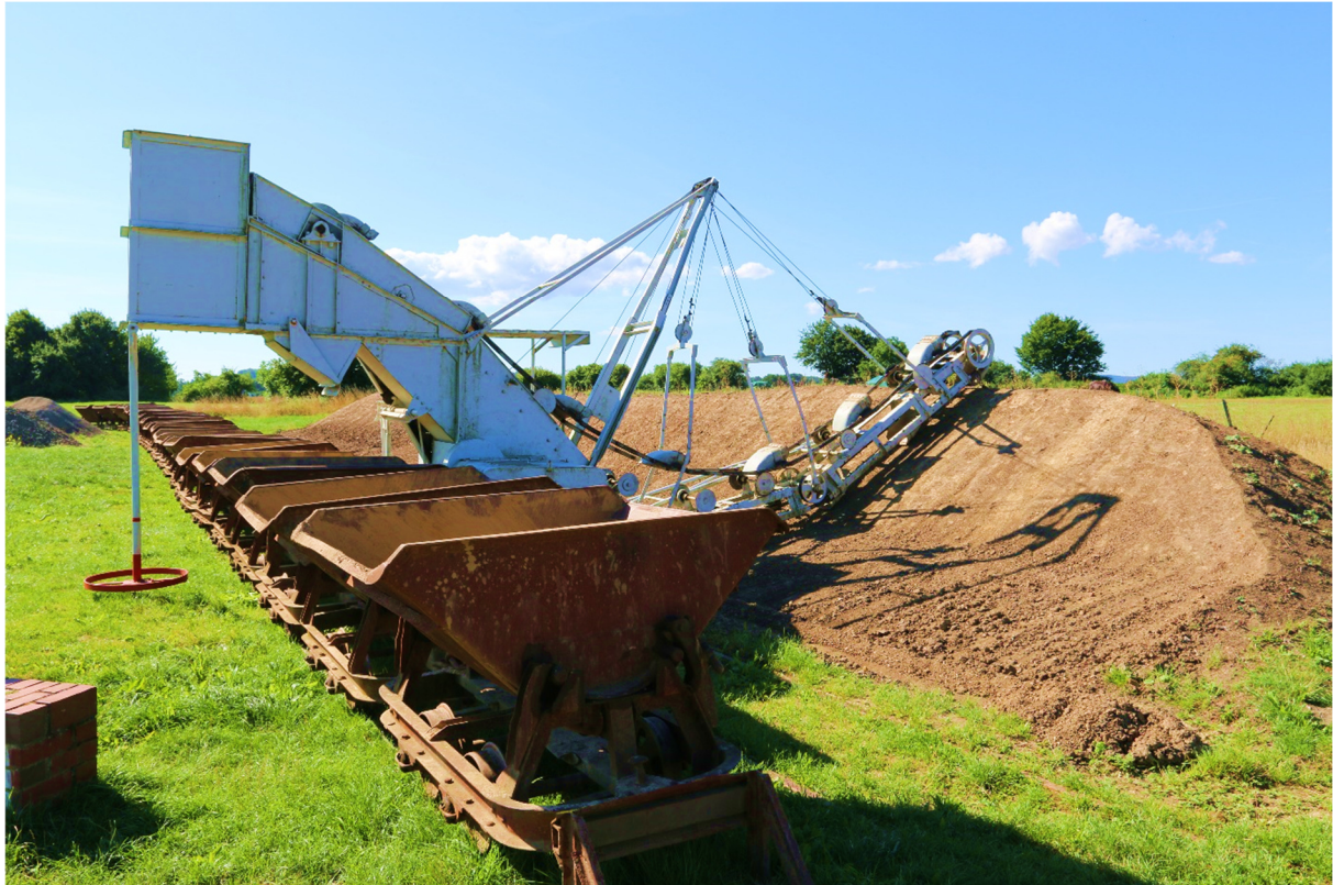
Symbolhafte Verdeutlichung des Feldbahneinsatzes auf einer Ziegelei: ein Eimerkettenbagger belädt im August im 2022 bereitstehende Kipploren im LWL-Museum Ziegelei Lage (Foto: Konrad Soppa)
